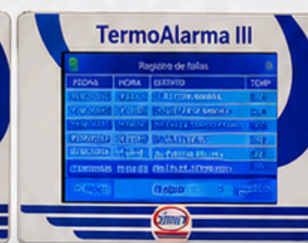
REGISTRO DE FALLAS
